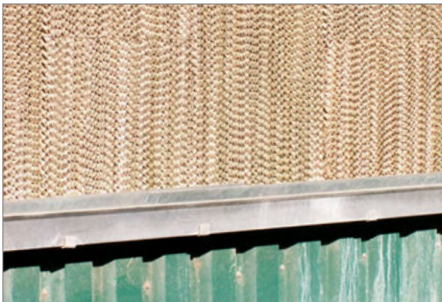
Zuluft-Kühlelement, integriert in der Außenwand eines Schweinestalls
