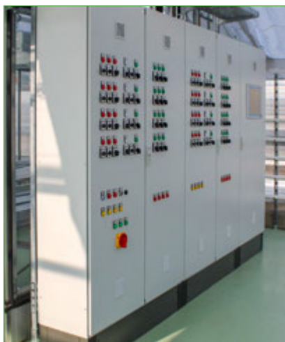
Steuereinheit der Kabinen
